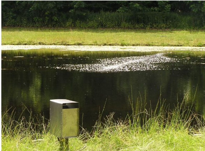
Iltning af sø med lavtrykskompressor og bobleslange
